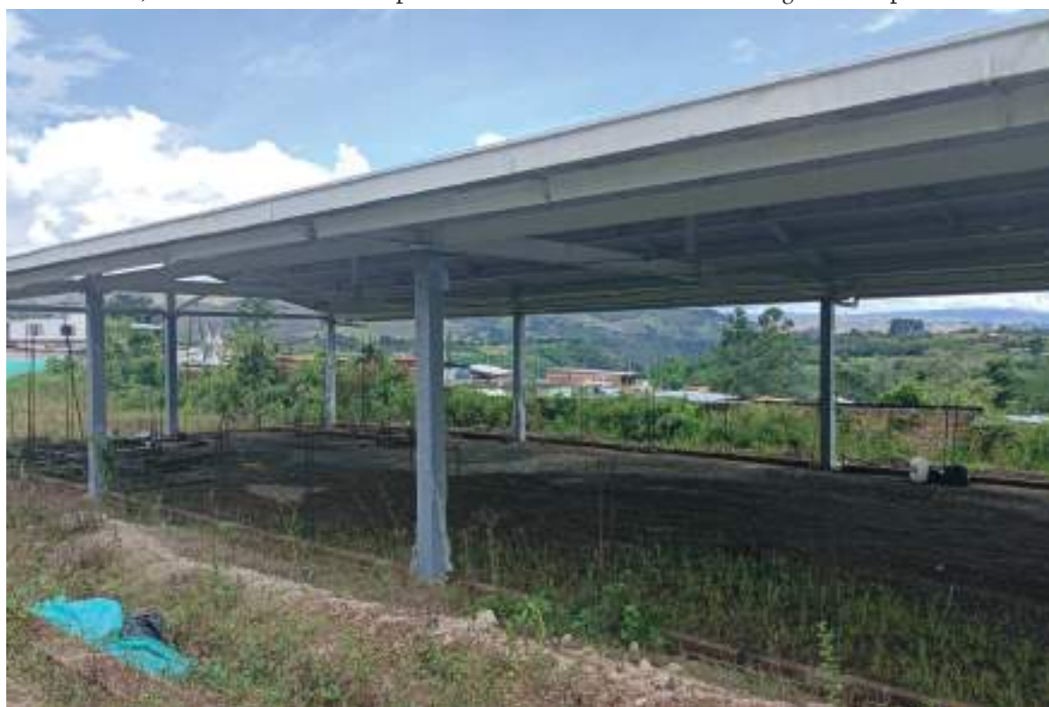
Esto fue lo que quedó de la obra del colegio La Felicidad
