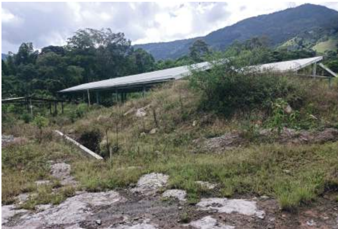
La obra está en total abandono
