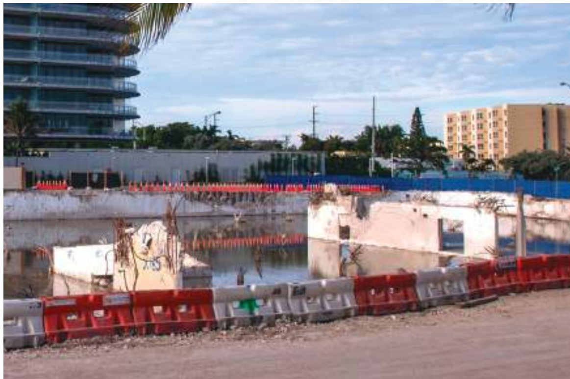
Registro general el pasado sábado del lugar donde solía estar ubicado el edificio Champlain Towers South, un mes después de su colapso, en Surfside.
