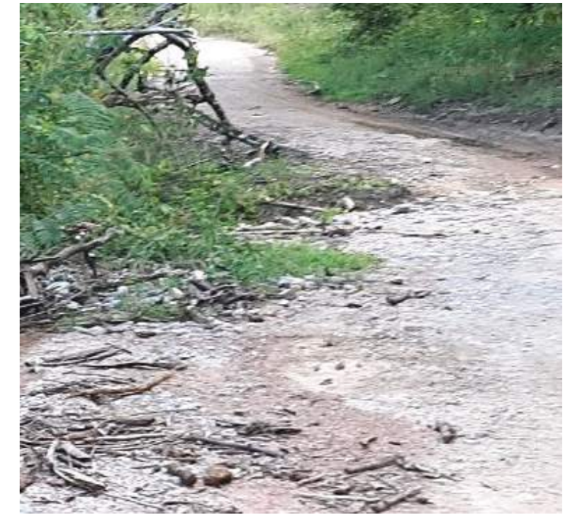
La comunidad ante dicho deterioro se ha visto obligada en constantes ocasiones a arreglarla por cuenta propia.
