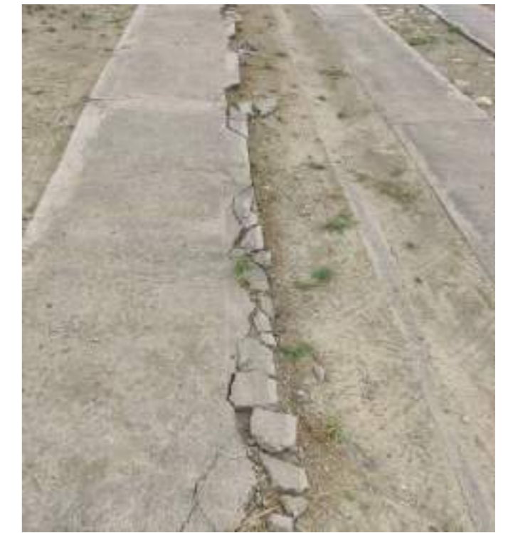
Algunos de los senderos se han ido deteriorando.
