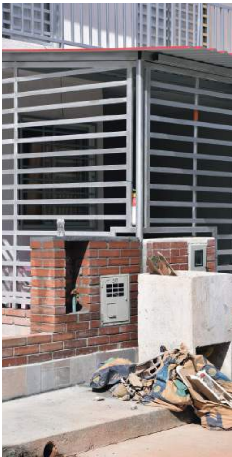
Las casas cuentan con las acometidas para el servicio de gas domiciliario, pero no tienen gas.
