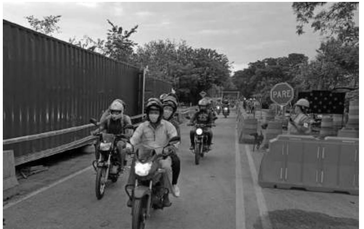
Desde el miércoles, 13 de abril se restableció el paso por un carril para vehículos livianos y motocicletas, en el puente del Río Arenoso.
