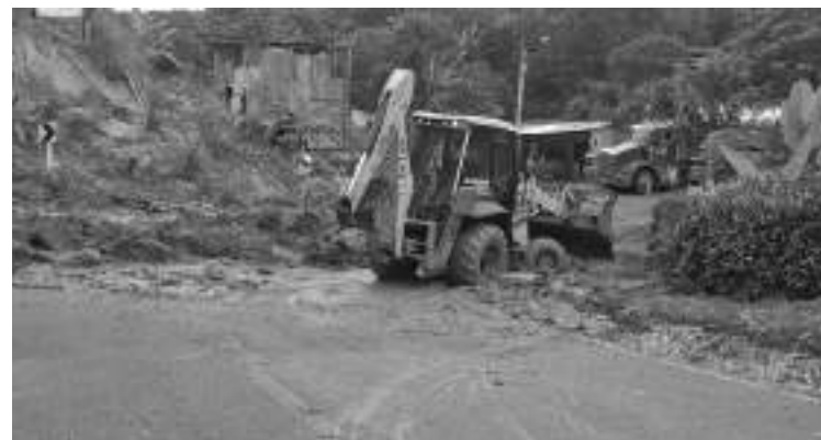
Deslizamiento de tierra en el sitio conocido como Aguazul, entre el municipio de Garzón y Altamira, ya fue superado.
