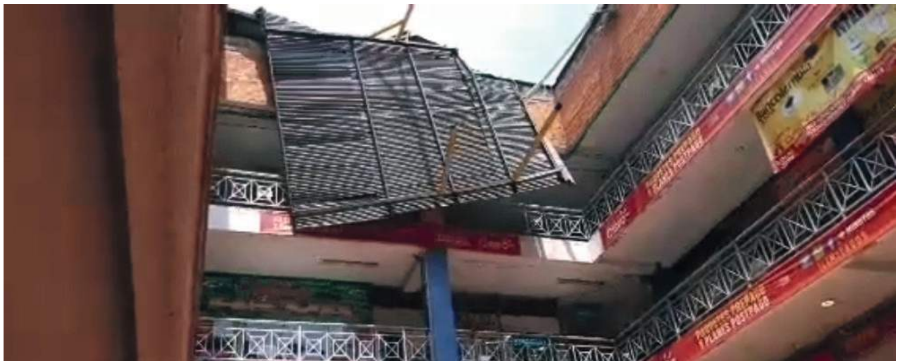
El techo colapsado del parqueadero privado en el centro comercial representa un riesgo para la seguridad de los comerciantes y de las personas que los visitan.
