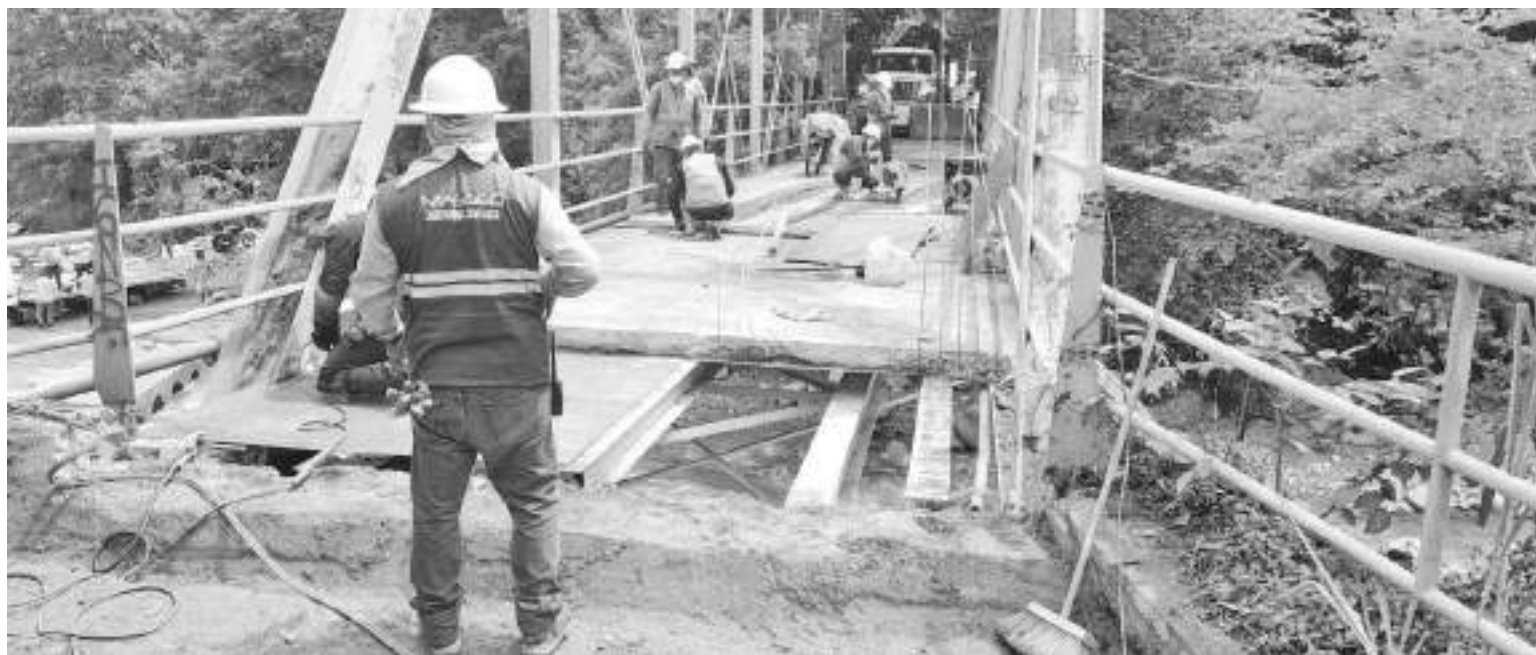
Las autoridades actúan de manera especial en la solución de movilidad de la Ruta 45, afectada por la creciente del Río Arenoso.
