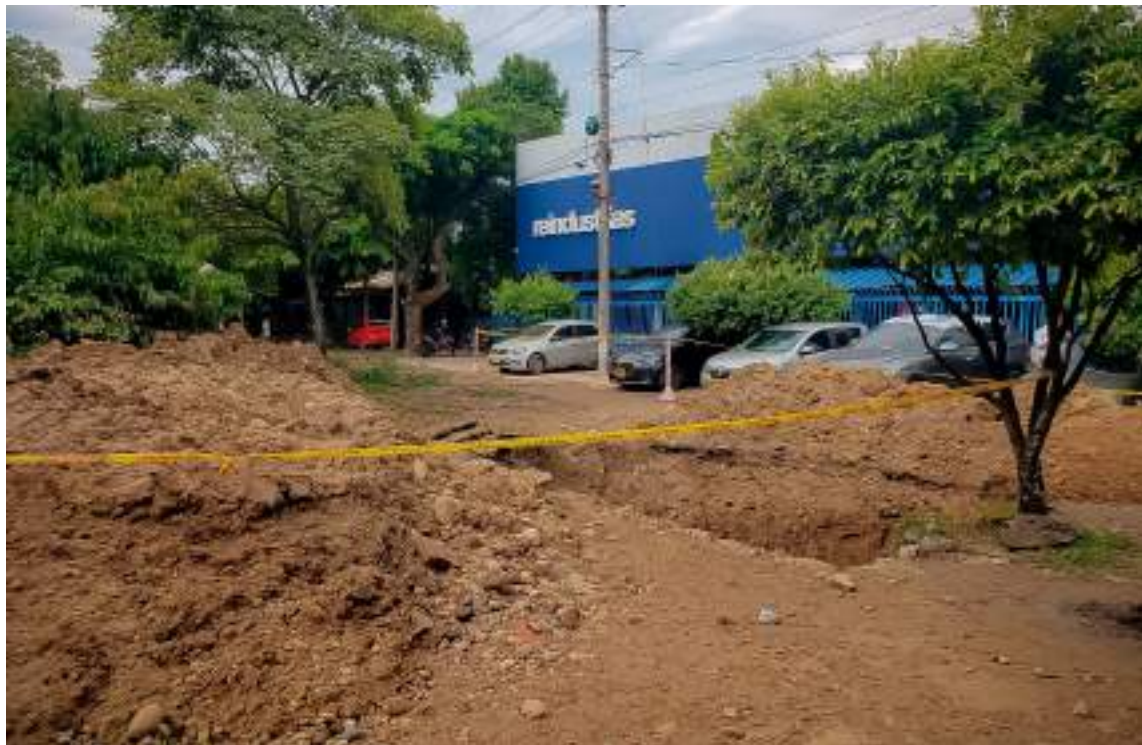
Sector de la carrera 16 donde se presentó la rotura de un tubo de 30 pulgadas.
