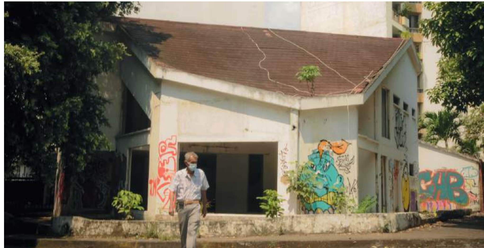
Vestigios de como se ha ido dismantelando la vivienda.
