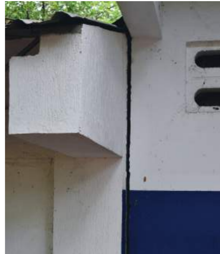
Uno de los muros que ha cedido en la sede la Gaitana.
