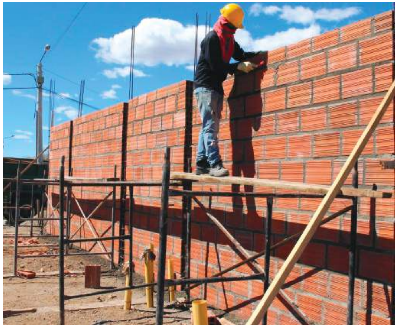
Con el déficit cualitativo se identifican aquellos hogares que habitan en viviendas con deficiencias que no son de carácter estructural.
