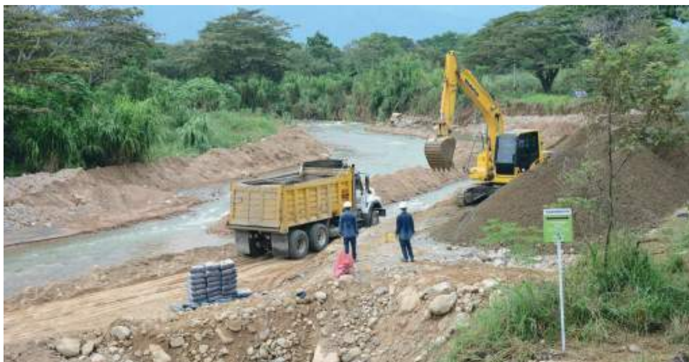
Las intervenciones de rehabilitación sobre el puente del río Arenoso se prevén estar listas para el 20 de mayo de este año.
