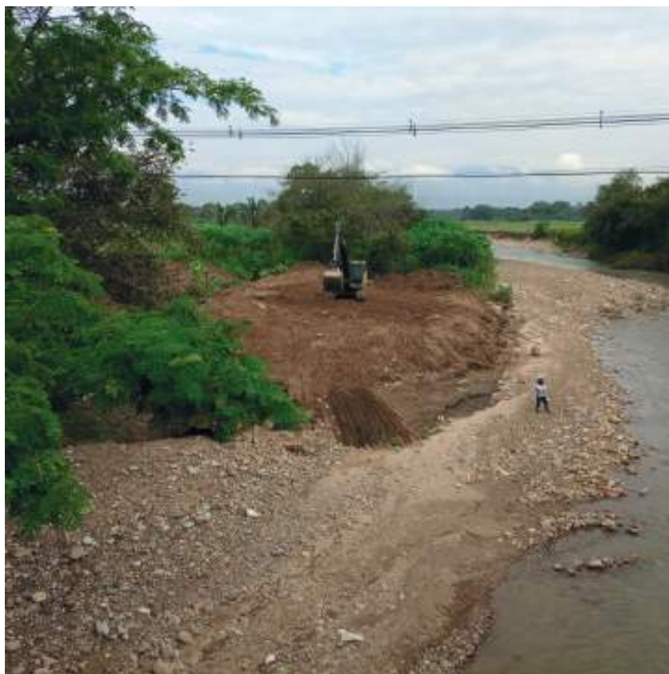
En caso de presentarse una creciente de grandes proporciones en la fase inicial del proyecto, puede afectarlo gravemente.
