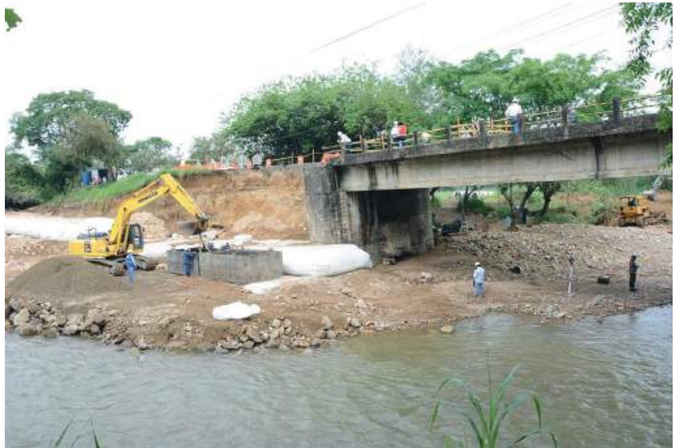
La primera fase de la obra que comprende una vía alterna, estará lista para este 20 de abril, indicó el Concesionario.
