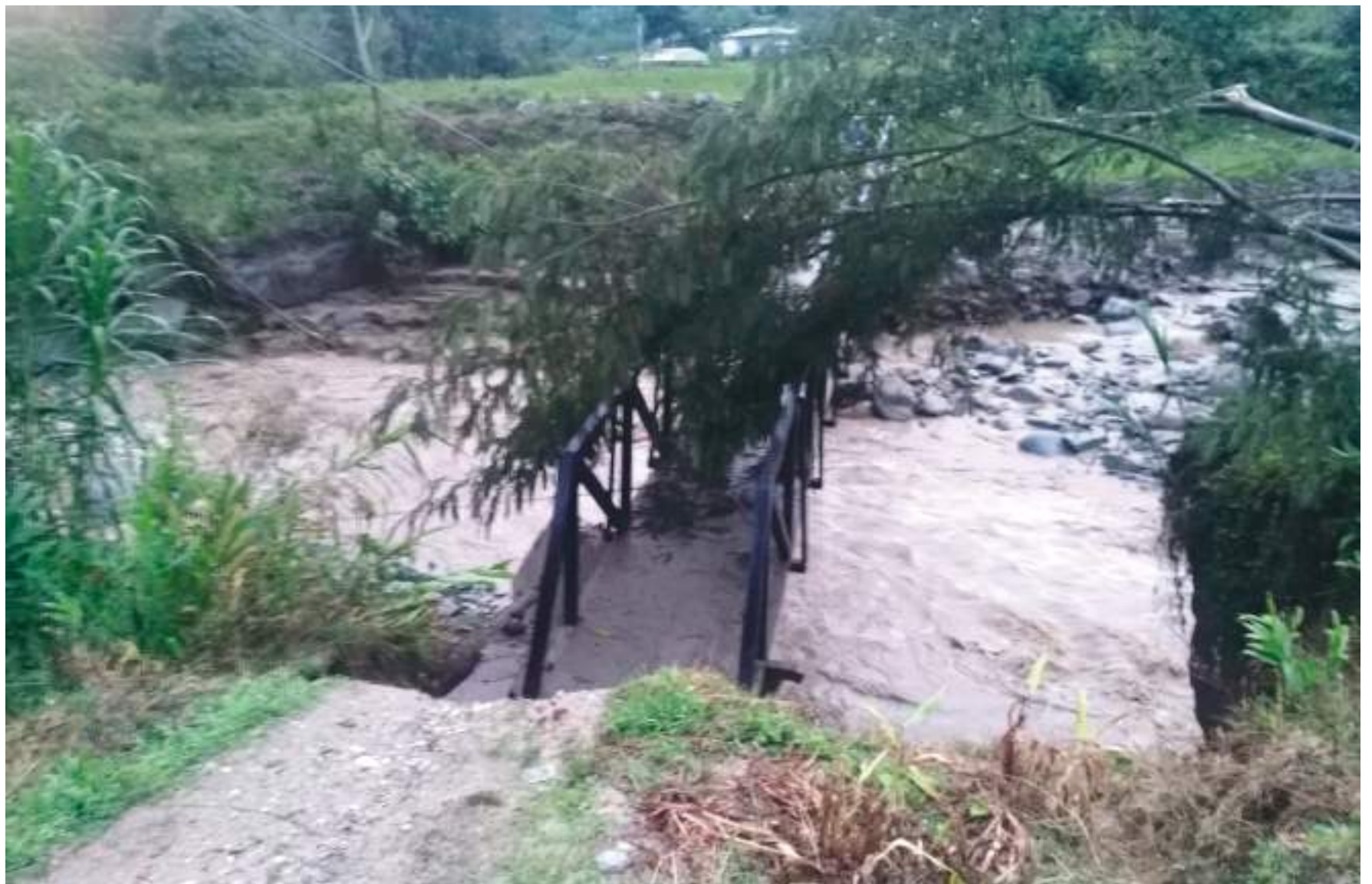
Los puentes peatonales de la zona también se encuentran averiados.
