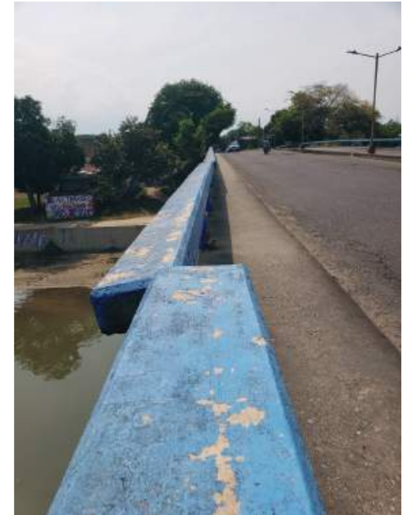
En el sentido norte sur una de las barandas amenaza caer a río.
