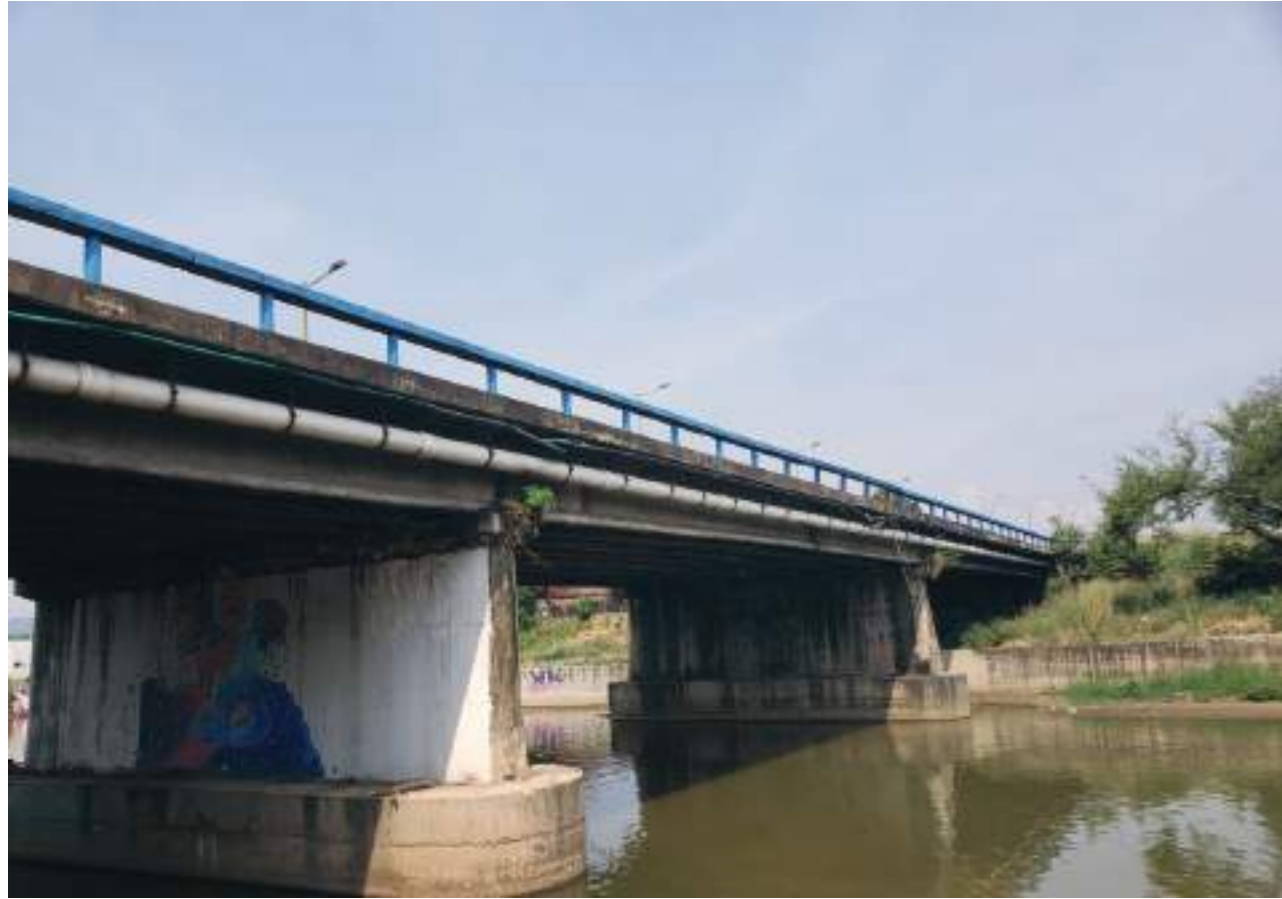
Puente Misael Pastrana Borrero de Neiva en evidente deterioro
