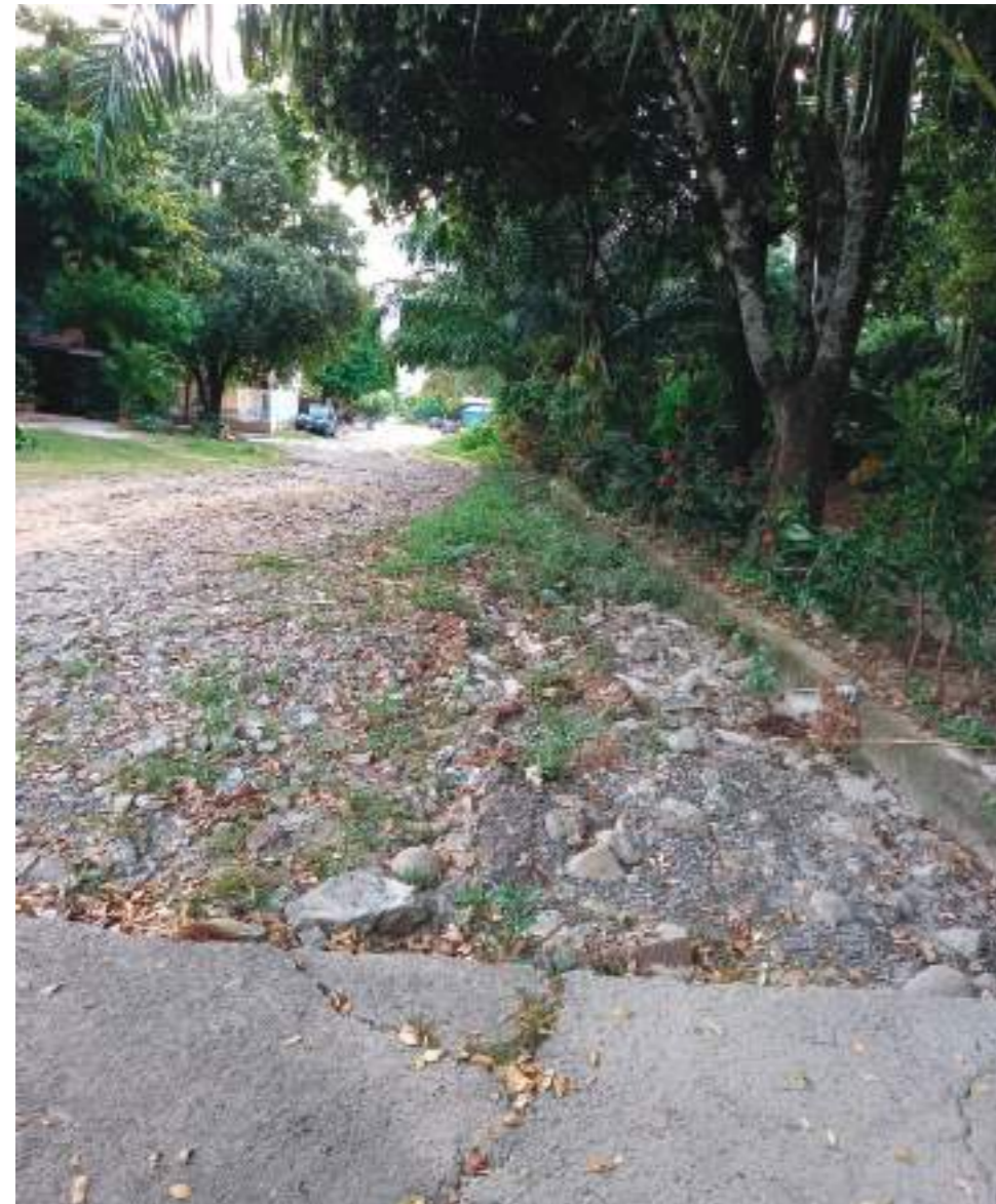
Estado actual de la calle 51 en Alamos Norte.
