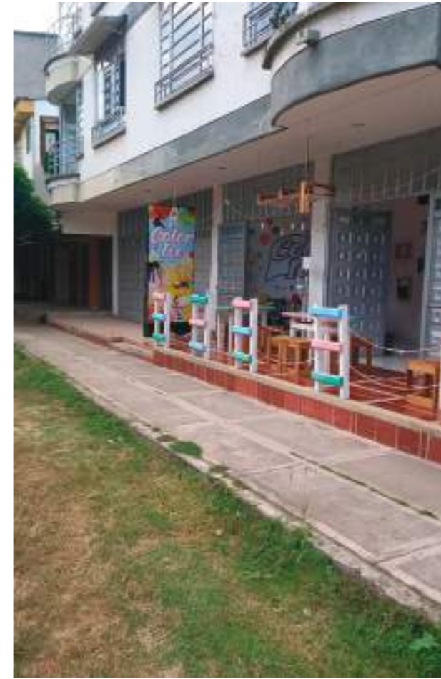
Los andenes se han ido dañando con el paso del tiempo.
