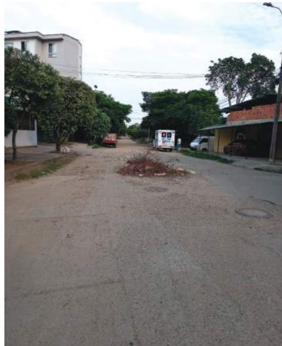
Lo poco que se pavimento se ha ido deteriorando.
