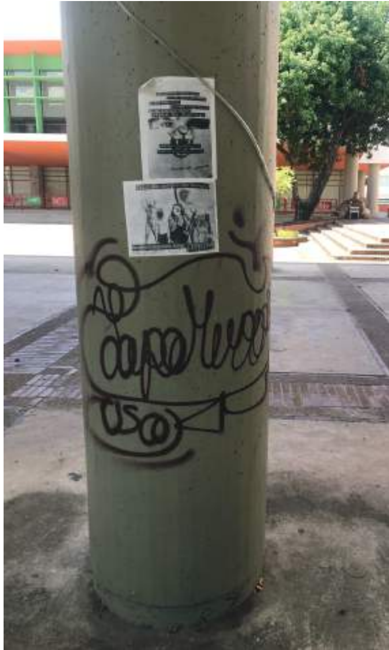
Los edificios no tiene dolientes, el deterioro en que se encuentran es notable.
