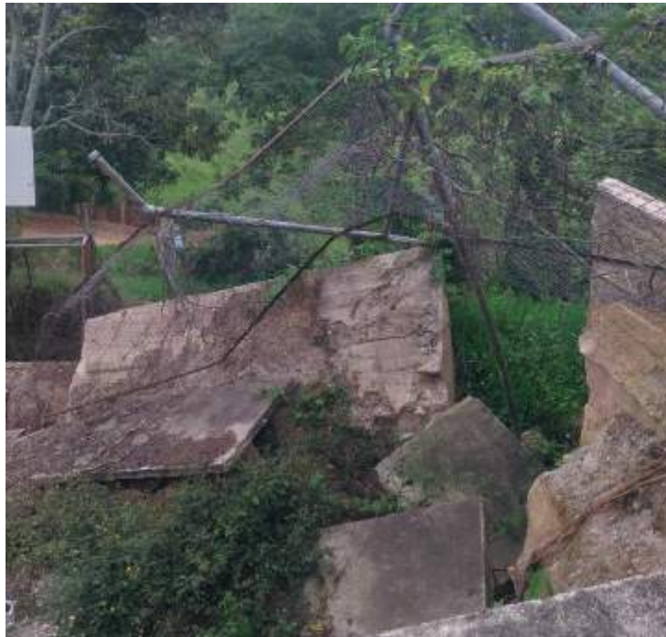
Parte de la cancha y el cerco de la sede Los Alpes, en Tarqui, se desprendieron hacia el abismo.
