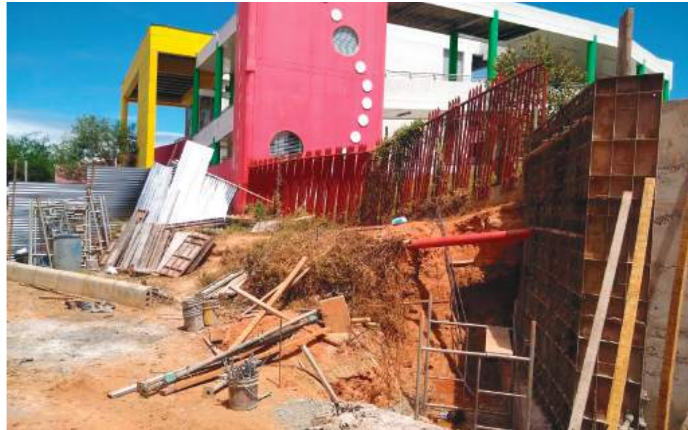
El muro de contención del Rodrigo Lara Bonilla será entregado este mes de septiembre.
