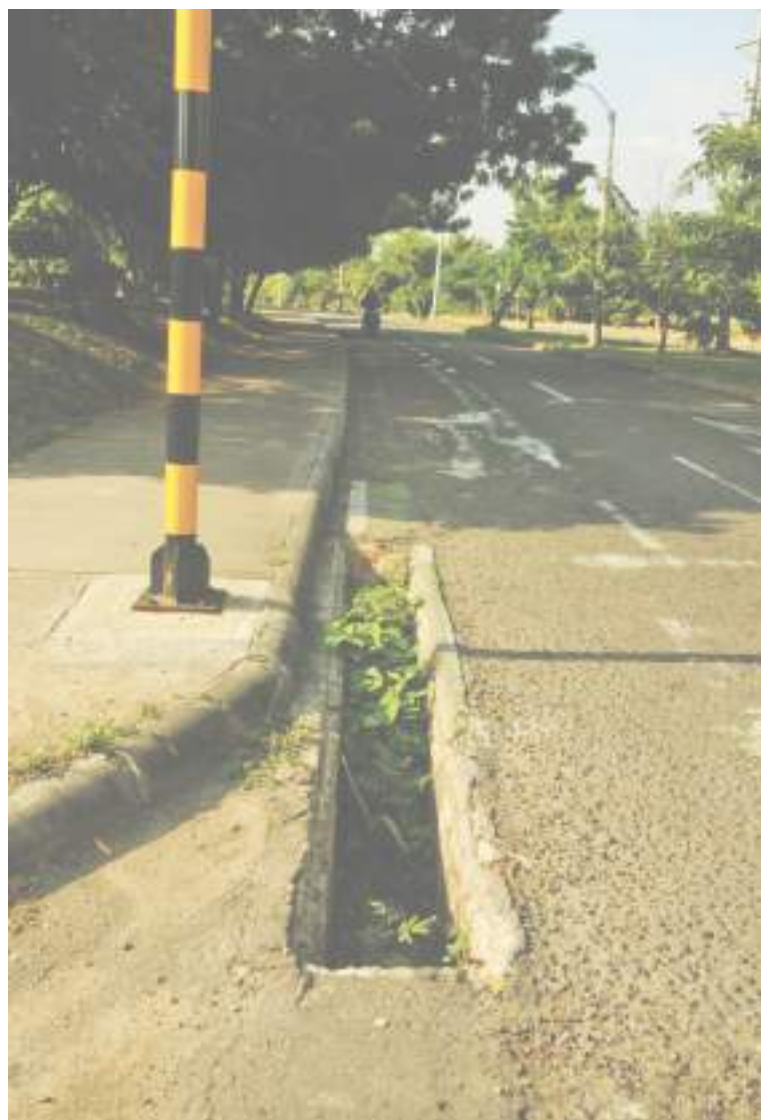
El robo de rejillas y tapas de alcantarillas son pan de cada día en Neiva.
