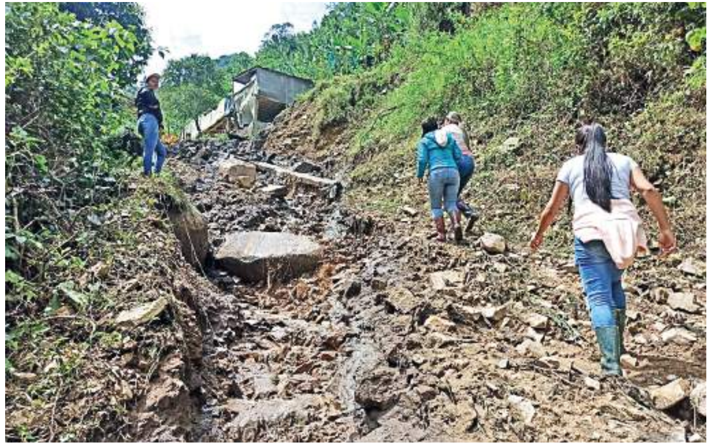
Múltiples han sido las afectaciones generadas por las fuertes lluvias en el departamento del Huila.
