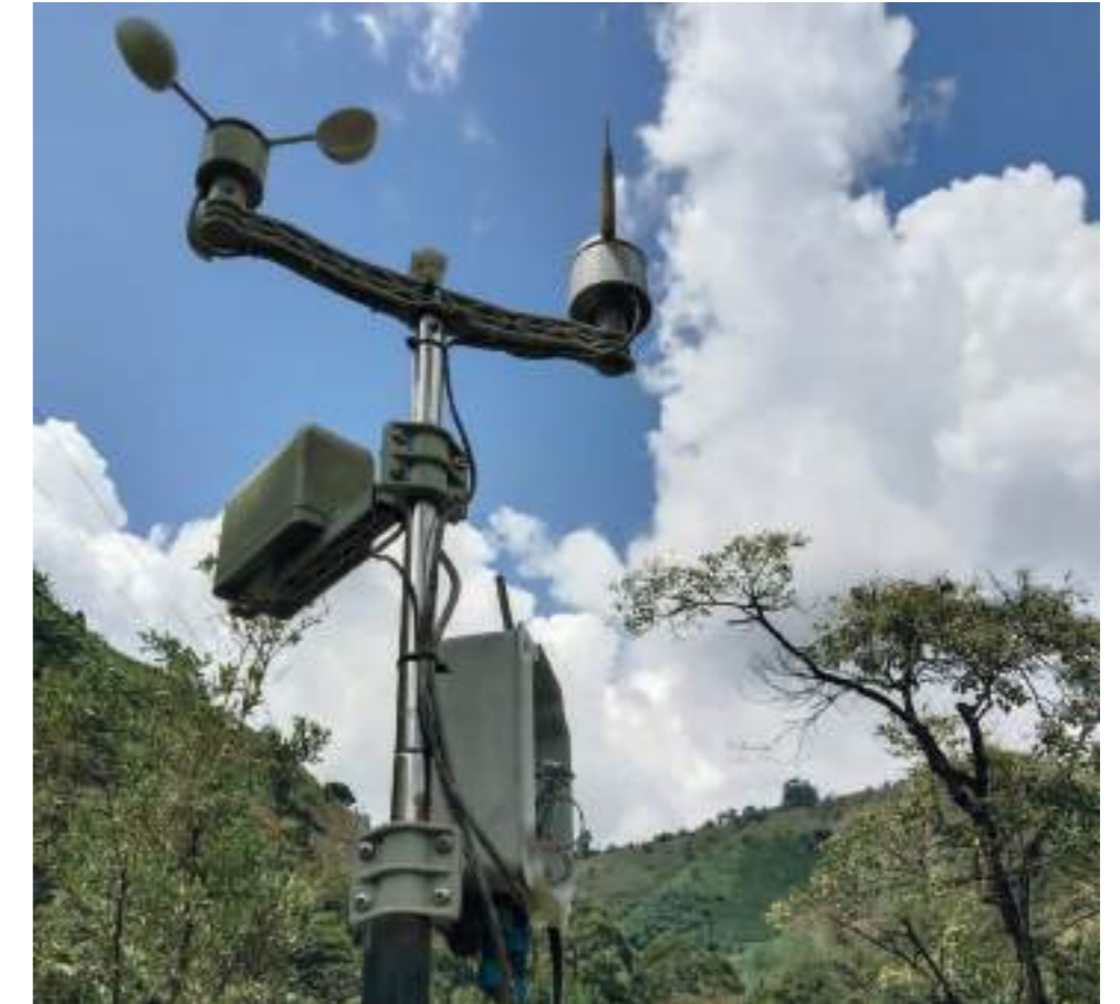
Alarmas como estas se instalan a lo largo de la cuenca del río Fortalecillas.
