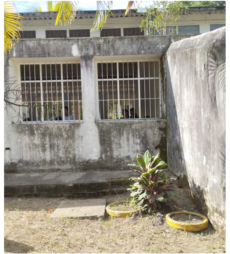
Mal estado de la sede principal de la Institución Ecopetrol en Campoalegre.
