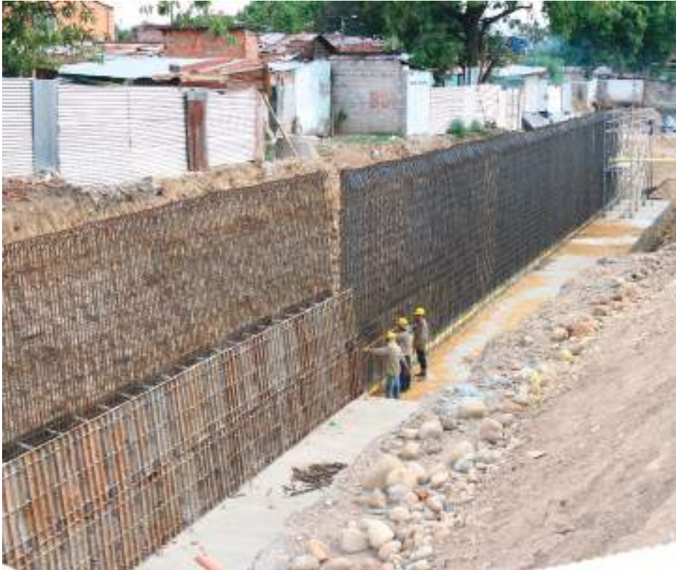
Actualmente se iniciará la octava fase de canalización del río Las Ceibas, con un valor cercano a los 3.000 millones de pesos.
