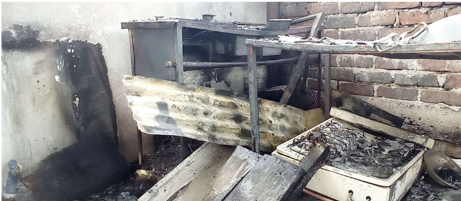
Agosto, octubre y diciembre, fueron los meses que presentaron mayor número de incendios estructurales en la ciudad de Neiva.
