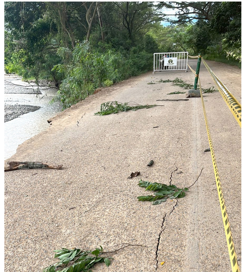
La vía presenta grietas aumentando las posibilidades de colapsar totalmente
