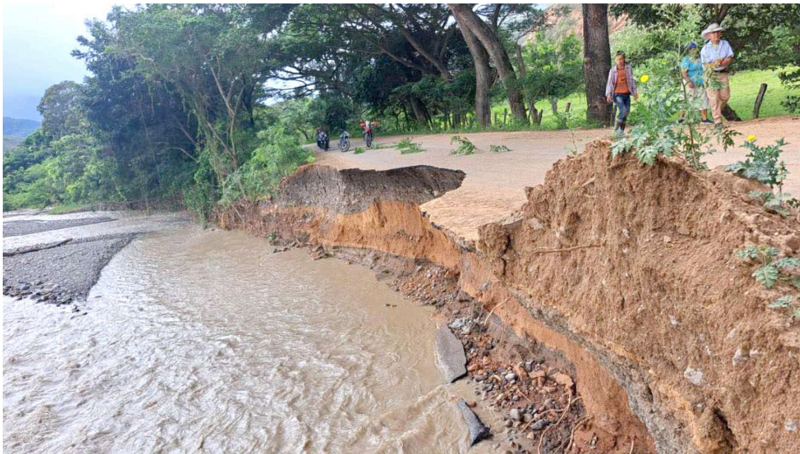
Las crecientes en el río deterioraron la entrada al municipio de Colombia
