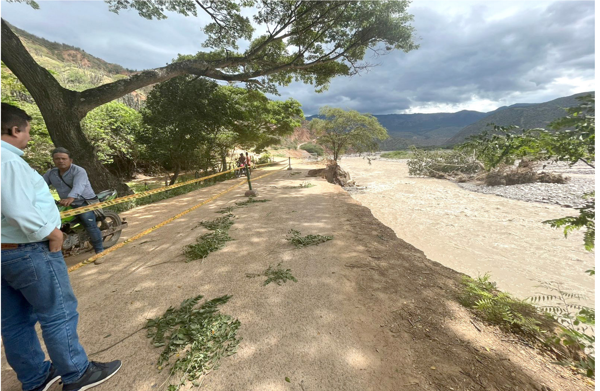
Parte de la carretera que queda tras ser afectada por la creciente del río Ambicá
