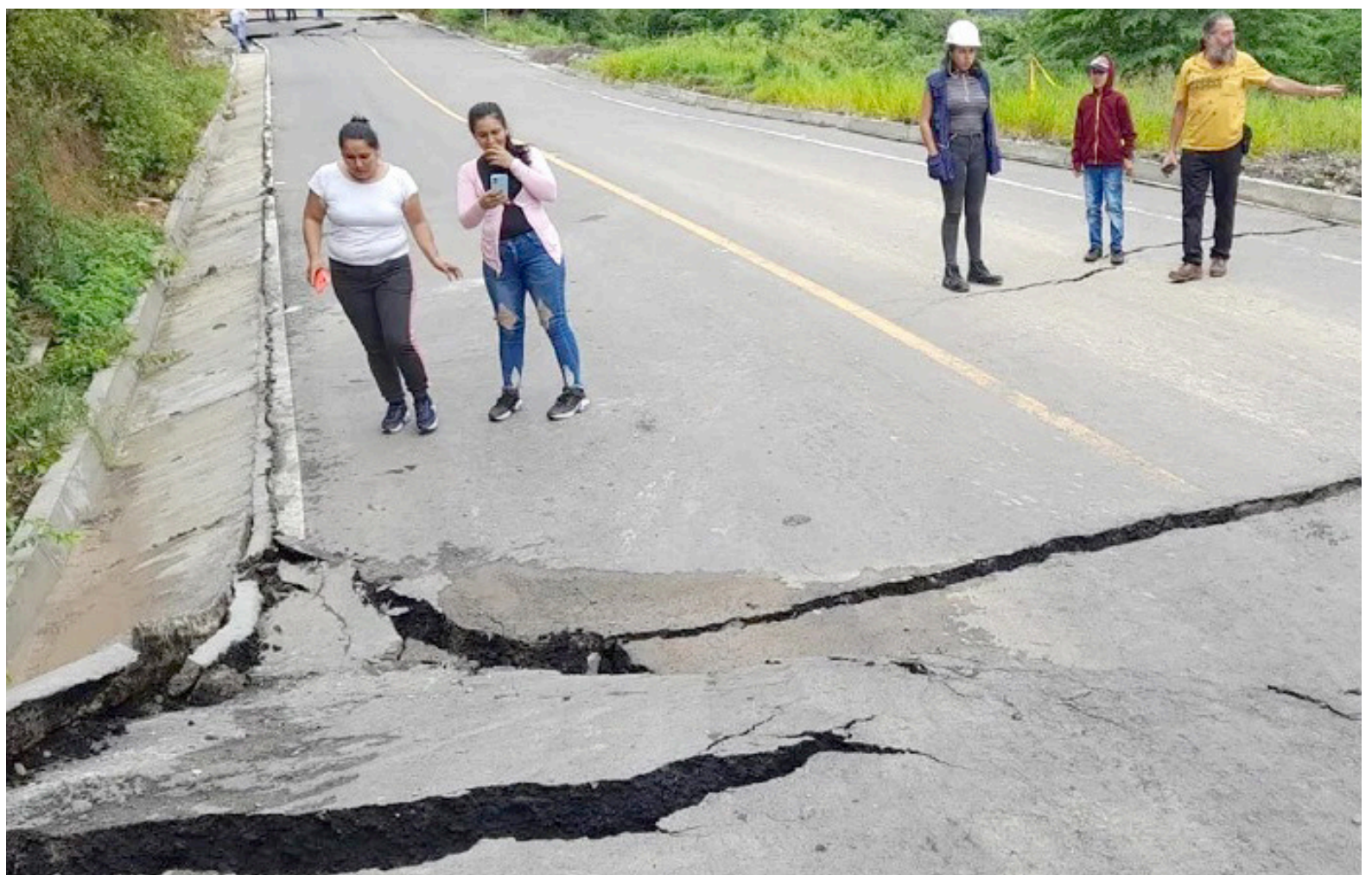
Grietas por la falla geológica que acabaron con la vía el pasado mes de abril de 2023
