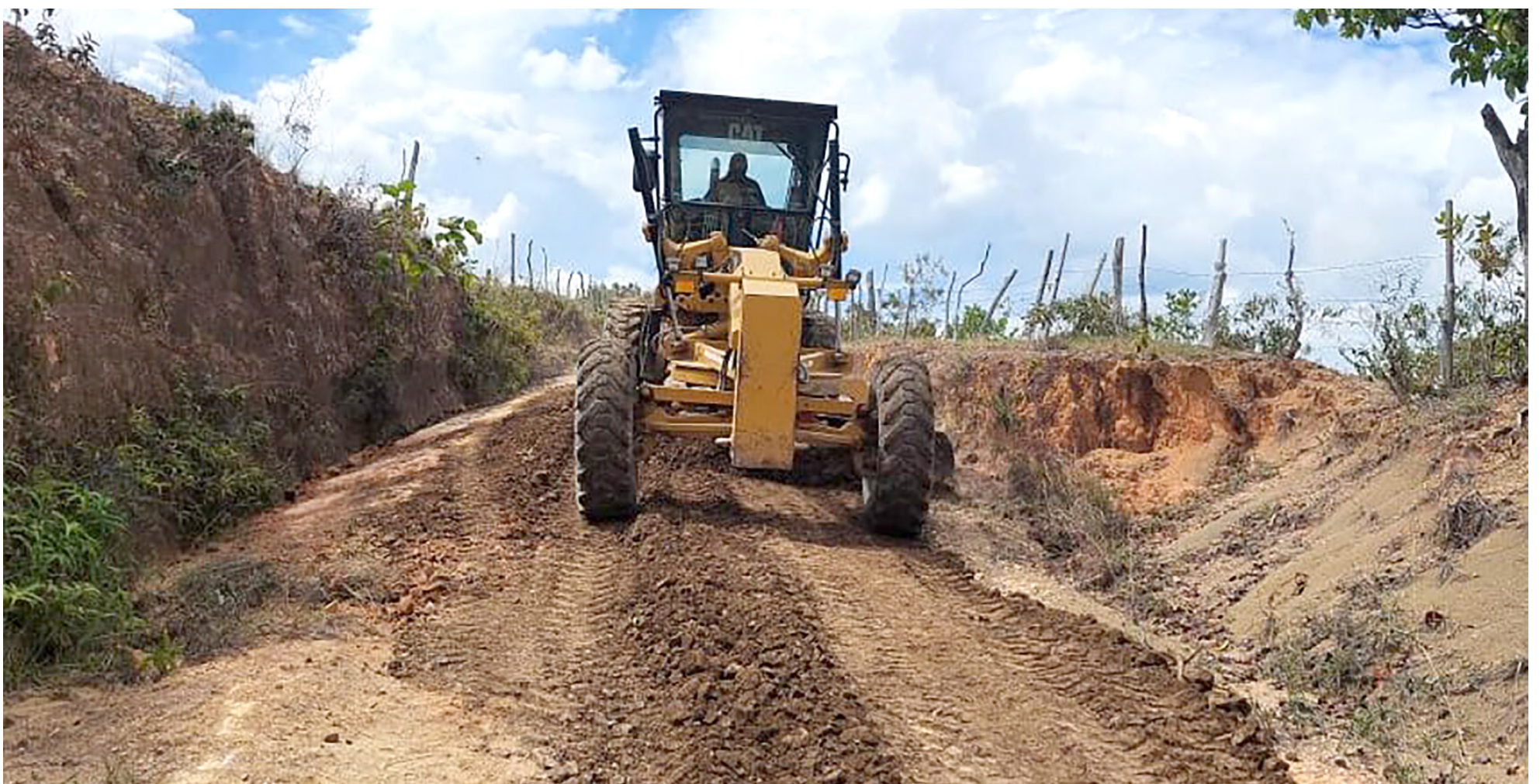
Las vías terciarias, las más perjudicadas.
