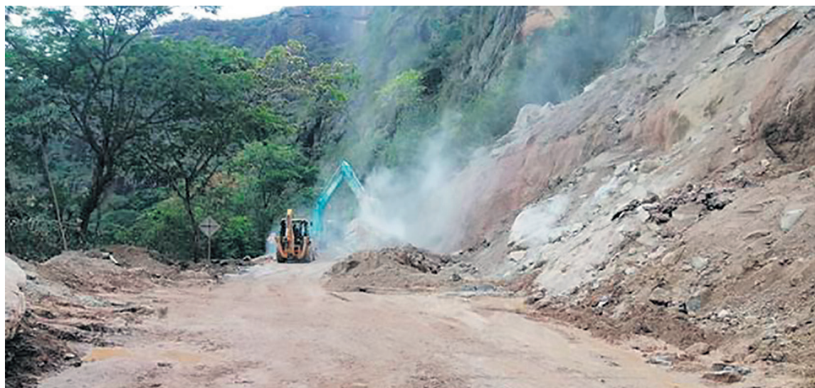
Se espera que una vez se realicen los estudios técnicos por parte de la Concesionaria, se pueda dar una solución definitiva al problema.
