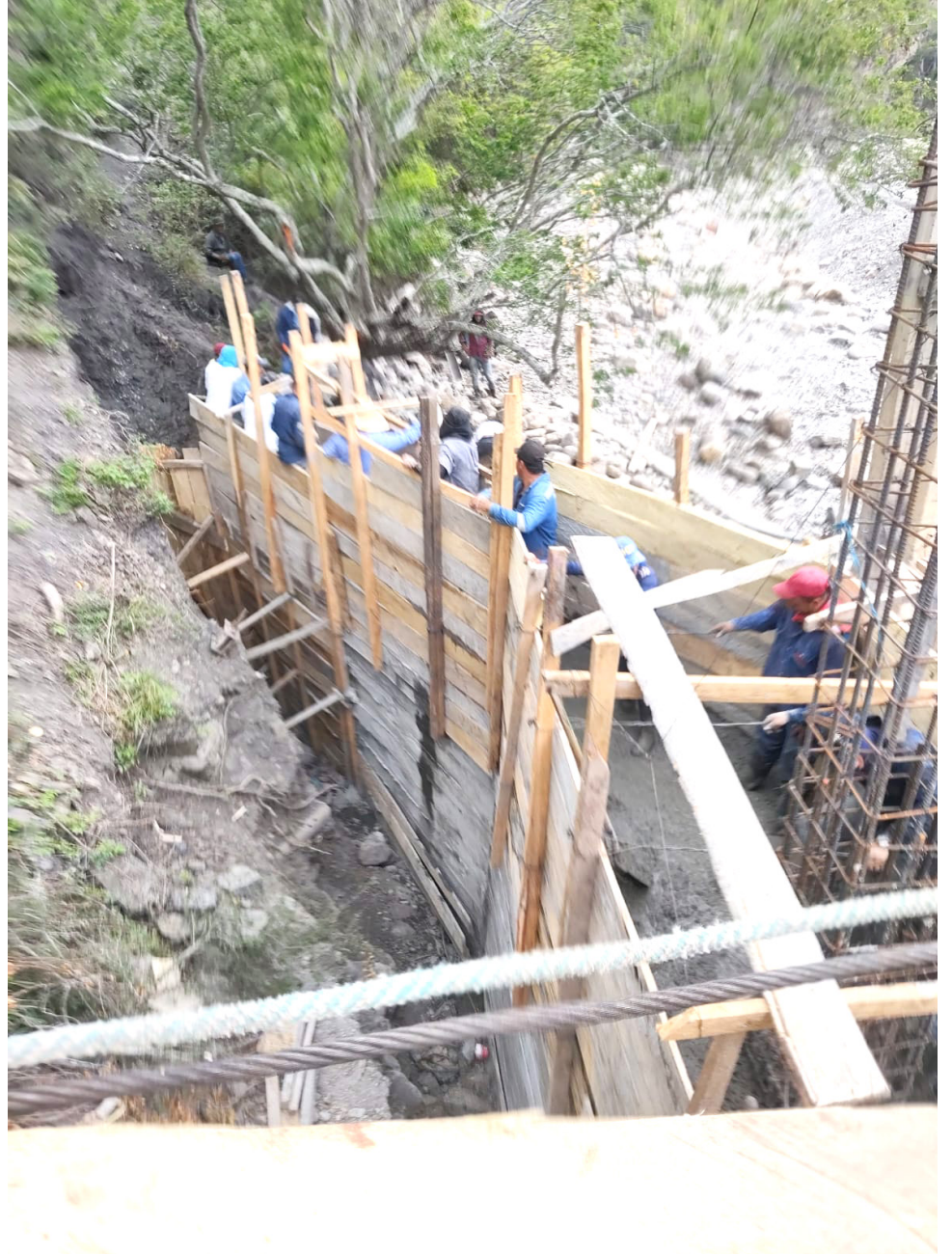
Habitantes de la zona rural y urbana del municipio iniciaron las obras del puente sobre el río Ambicá.
