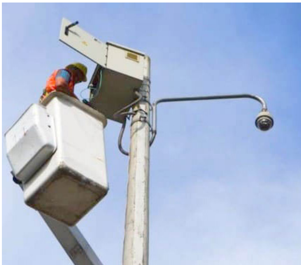
Una de las estrategias es la instalación de cámaras de seguridad.
