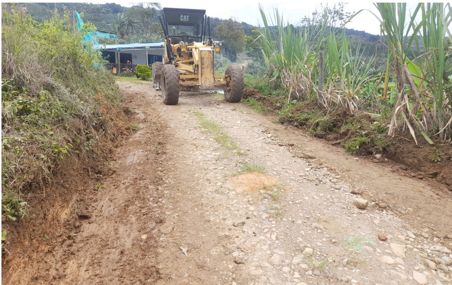
Con mingas, en Acevedo, tanto el gobierno municipal y las comunidades, buscan mejorar las vías secundarias y terciarias.
