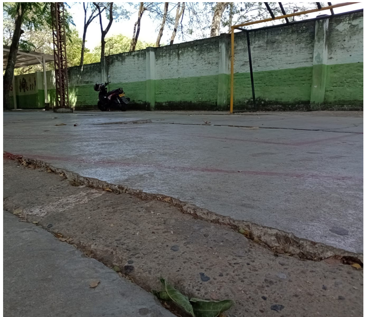
Así se encuentra el polideportivo de la escuela sede ‘La Contraloría’.
