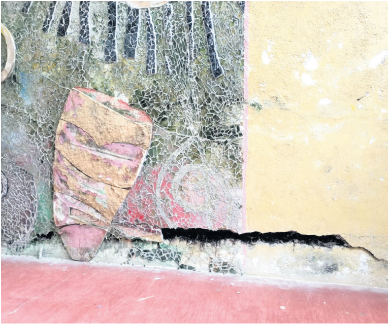
El colegio se encuentra en riesgo por afectaciones de una avalancha.
