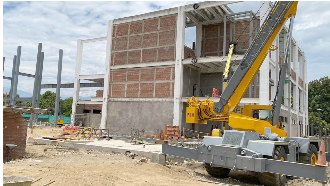
Los trabajos se suspenderán para subsanar temas de fisuras.
