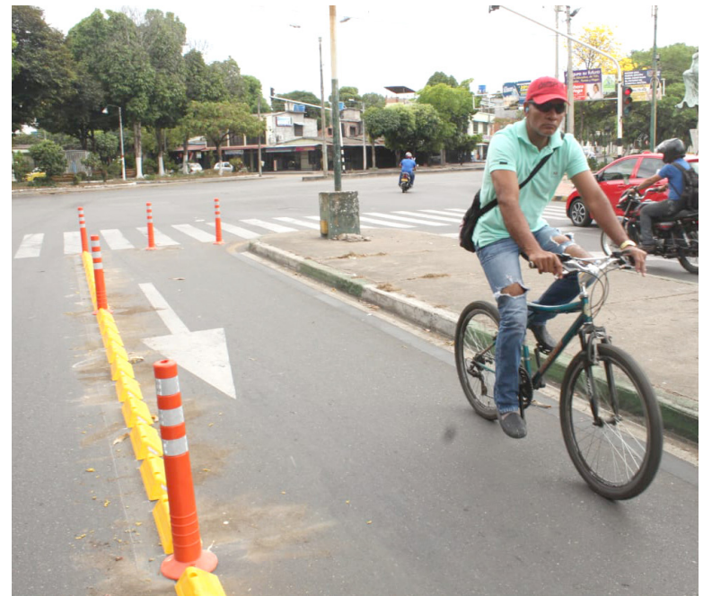
Cicloruta de la carrera 16 sin la demarcación correcta.
