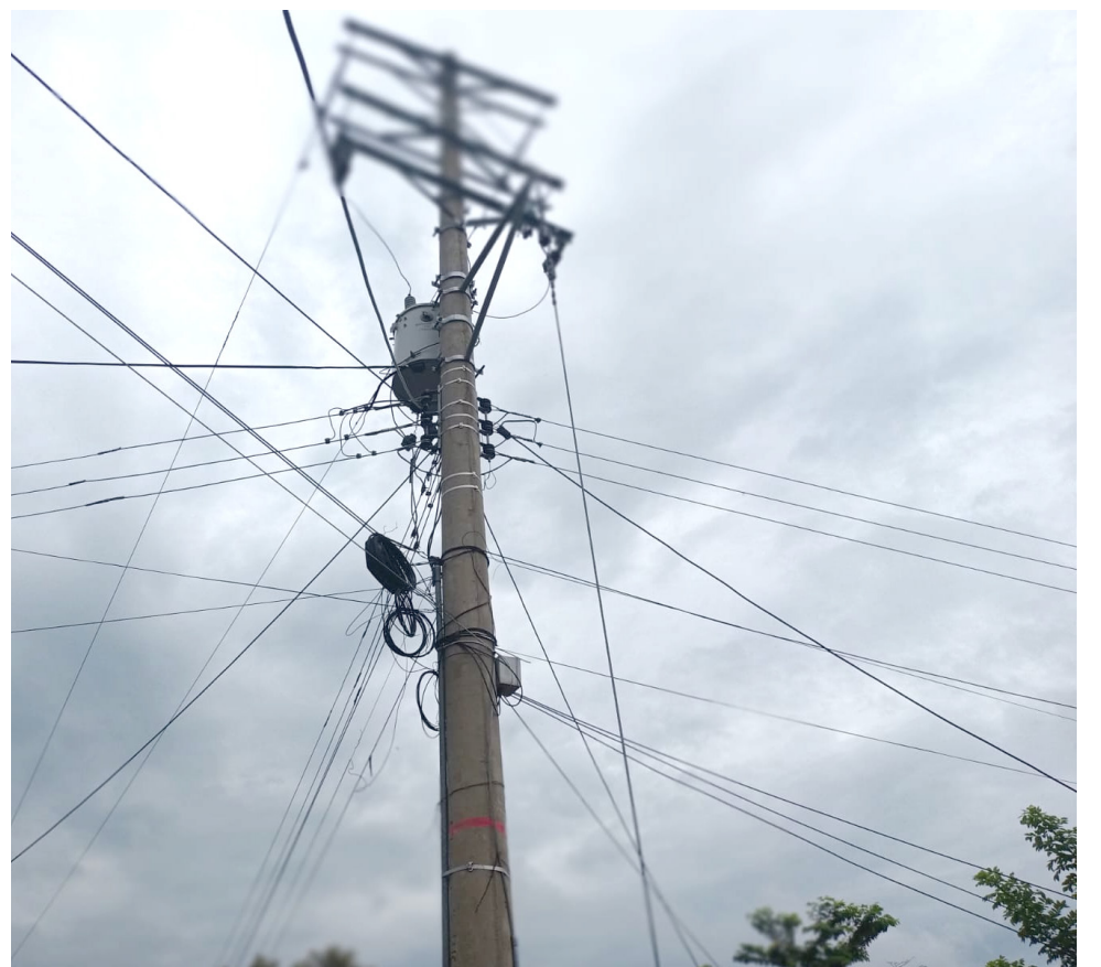
Las redes son de baja y fueron instaladas por la comunidad
