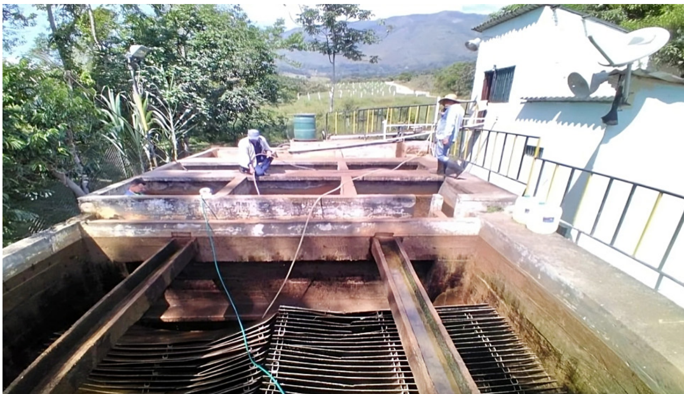
La red de acueducto actual ya cumplió su vida útil.
