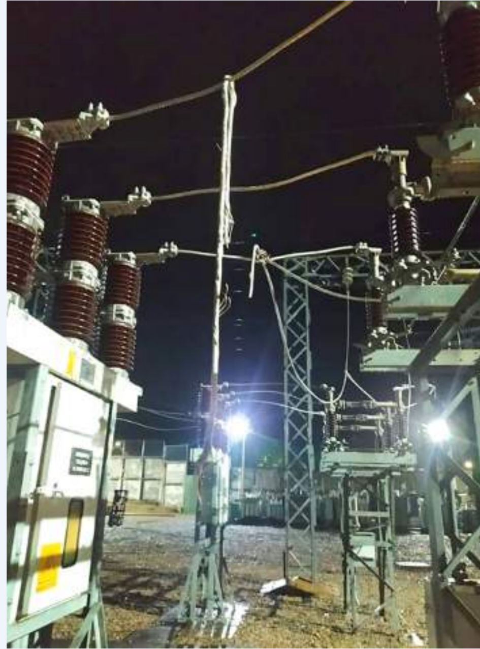
Daño en la estación del Bote ocasionó apagón en seis municipios del Huila.
