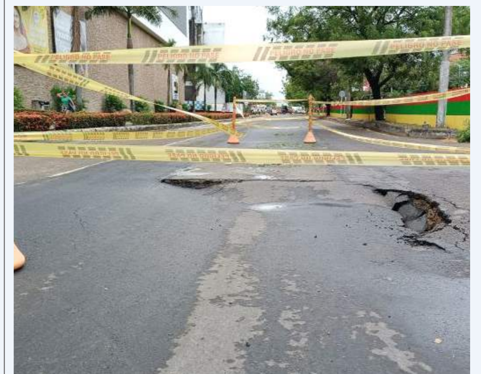
La vía quedó en estas condiciones.
