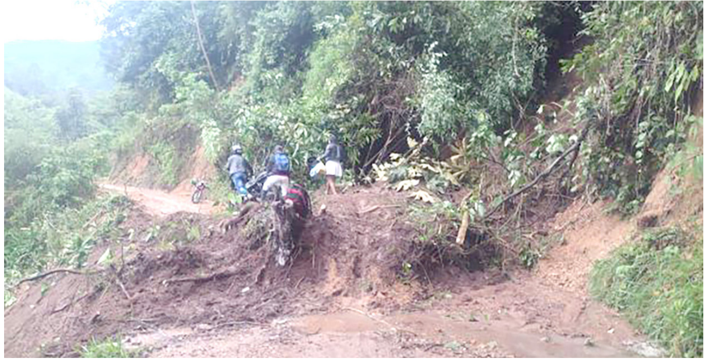
Deslizamiento en vía a Vegalarga
