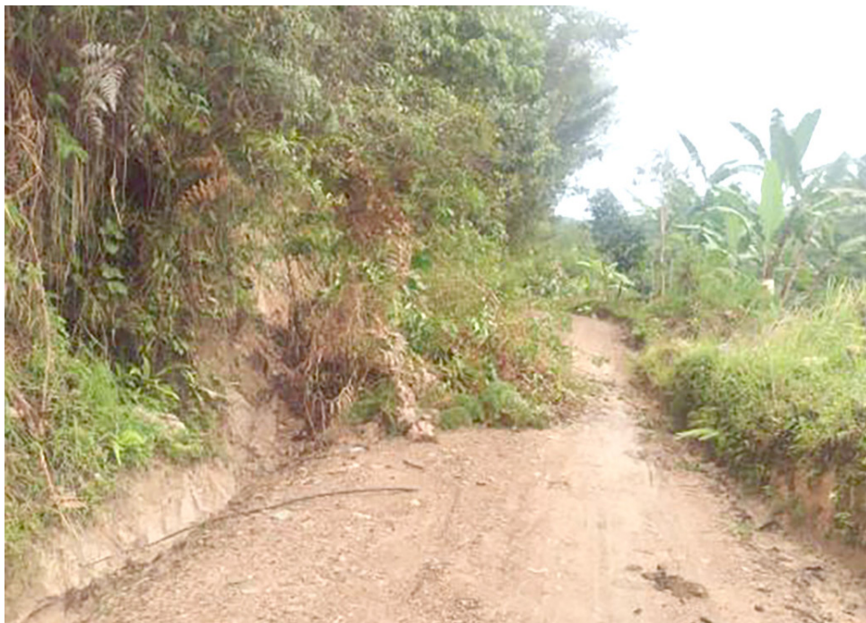
La vía quedó parcialmente obstruida
