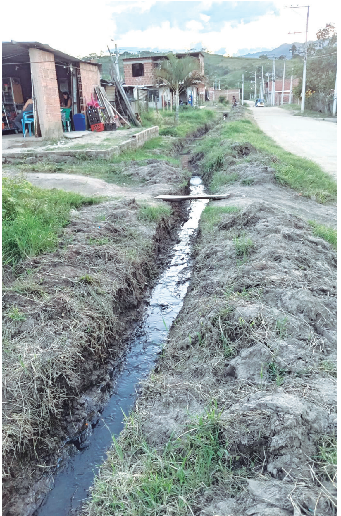
Las aguas residuales están expuesta en la calle; esto genera contaminación.
