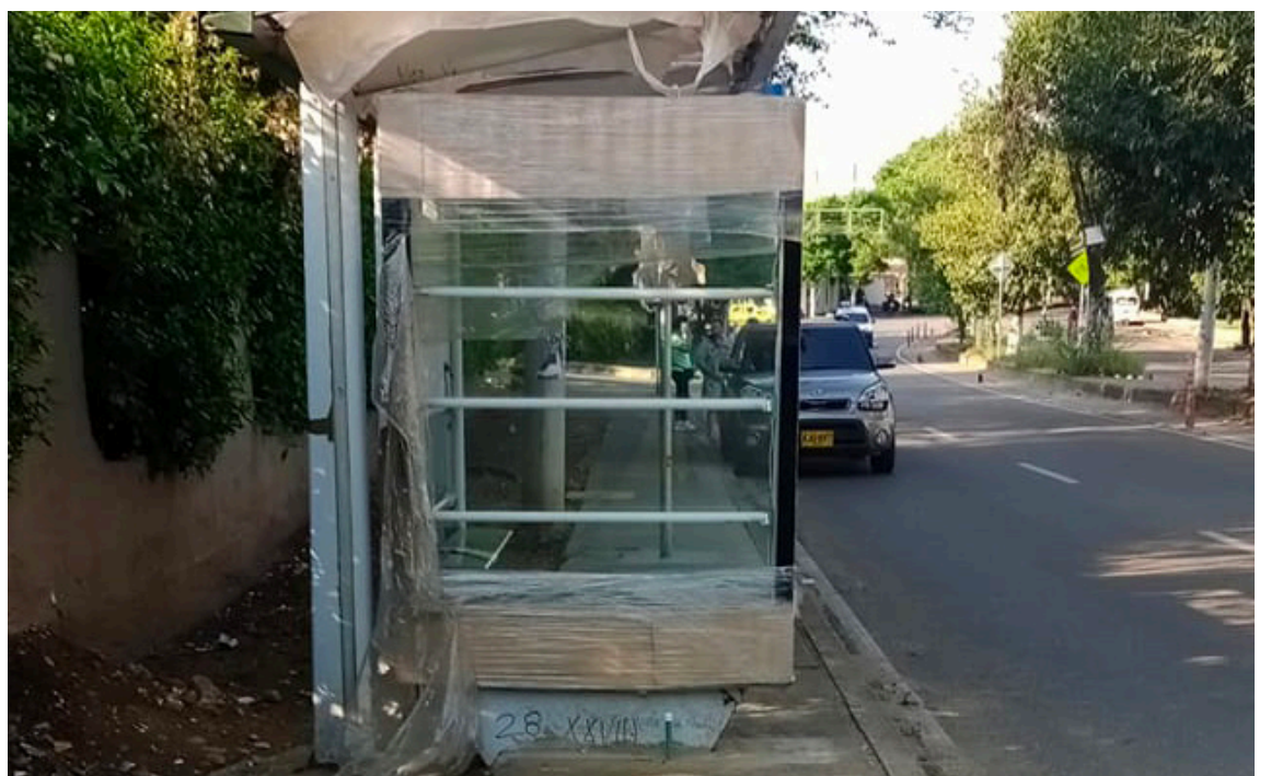
La mala planeación por parte de la oficina del SETP de la anterior Administración Municipal, a la hora de instalar sobre andenes los paraderos para el bus.
