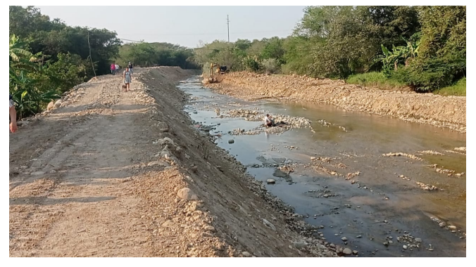
Se desplomó un muro de $400 millones ■ NEIVA 10-11
