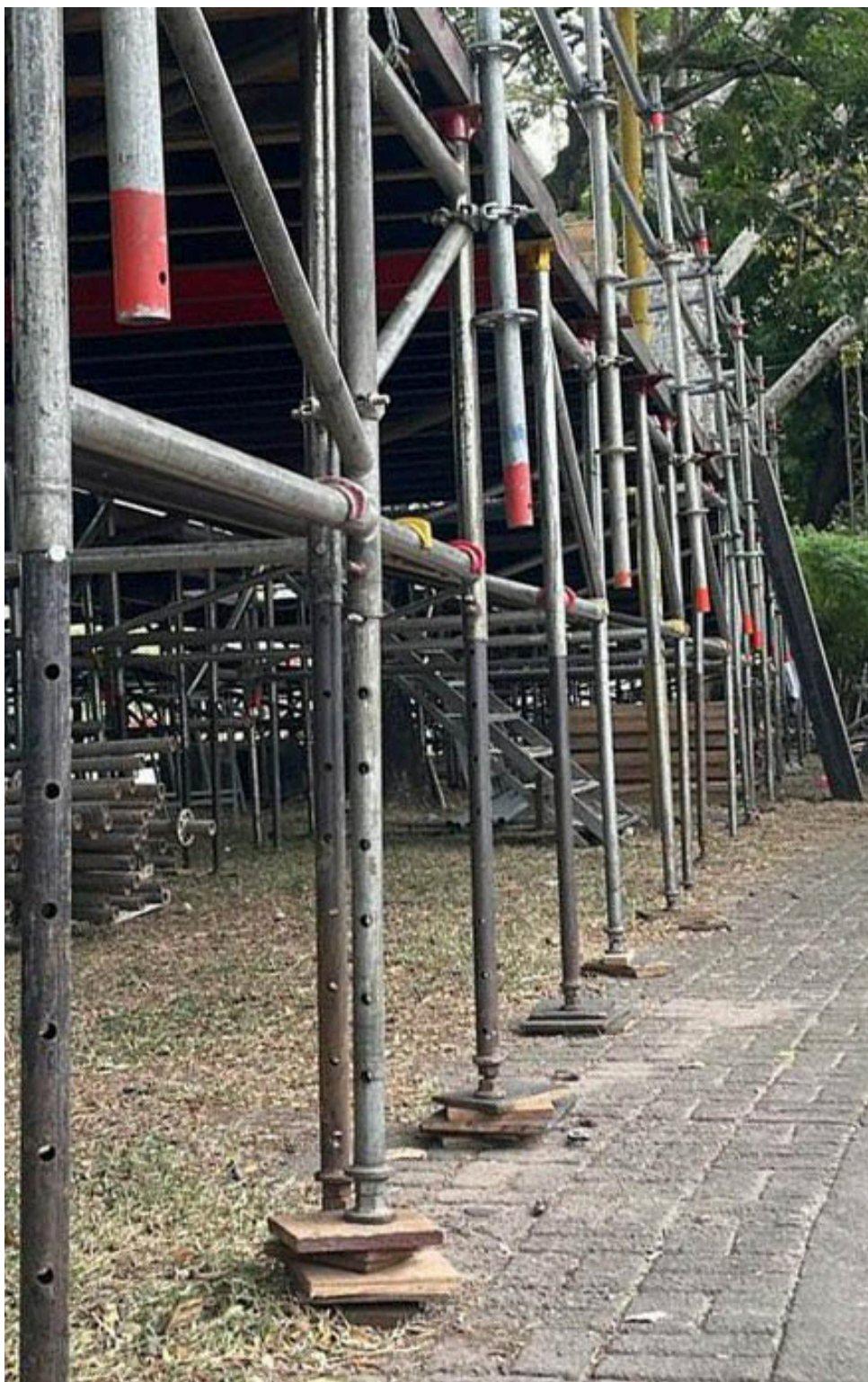
La Oficina de Gestión del Riesgo ya inició la visita a cada una de estas estructuras.
