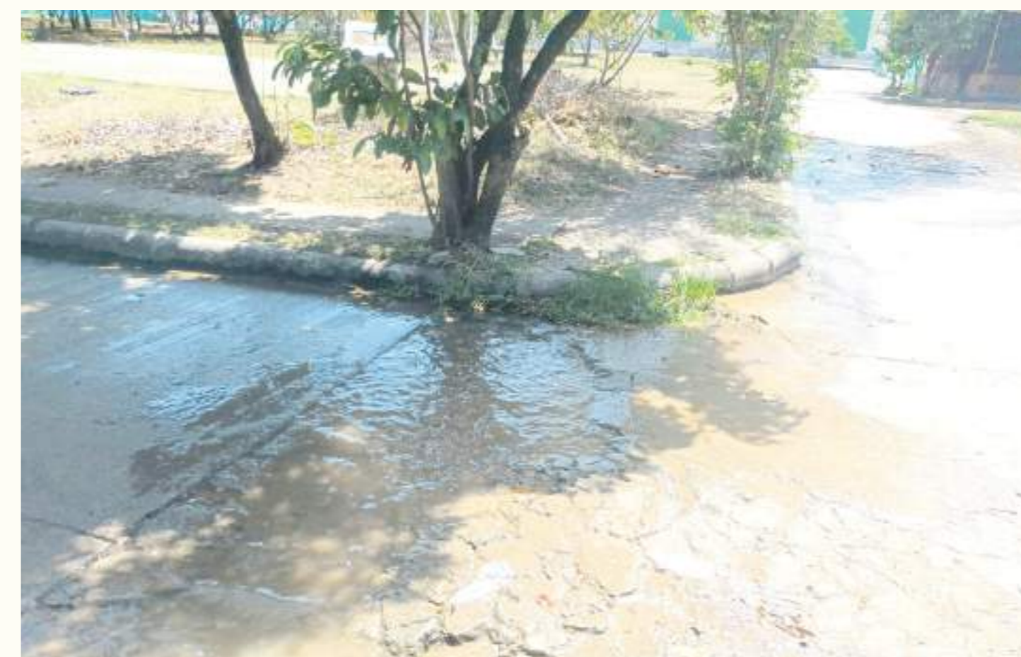
Daño en la zona del polideportivo, se está hundiendo la vía.
