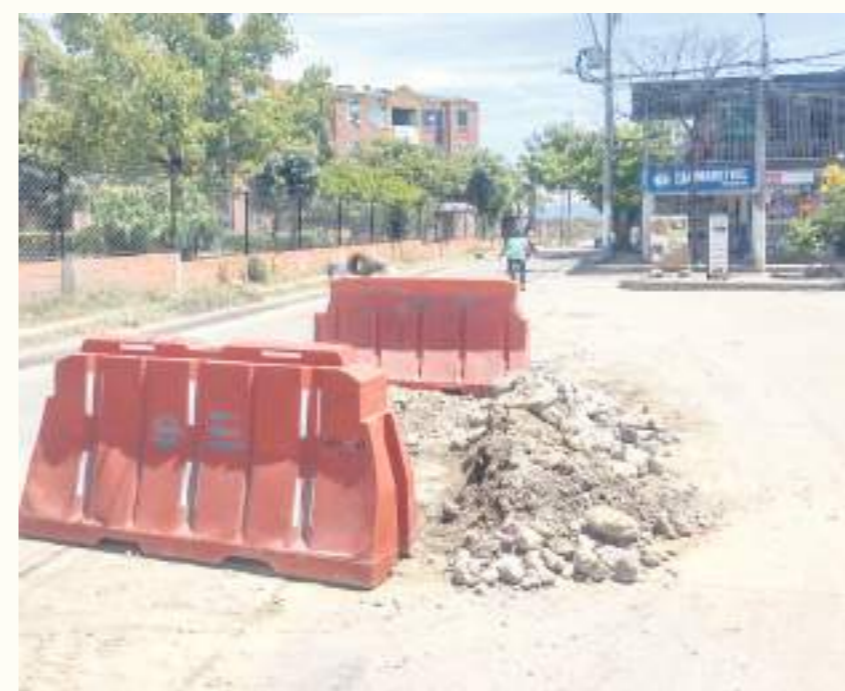
Vía principal que arreglaron, pero no han pavimentado.
