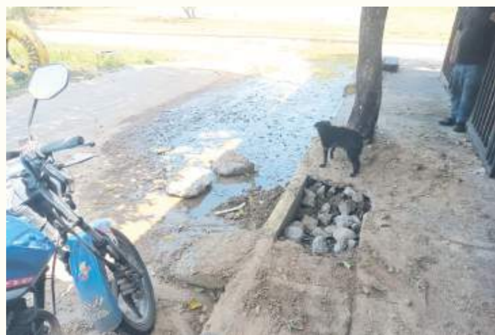
Daño permanente en acometida de una vivienda en San Luis de la Paz.
