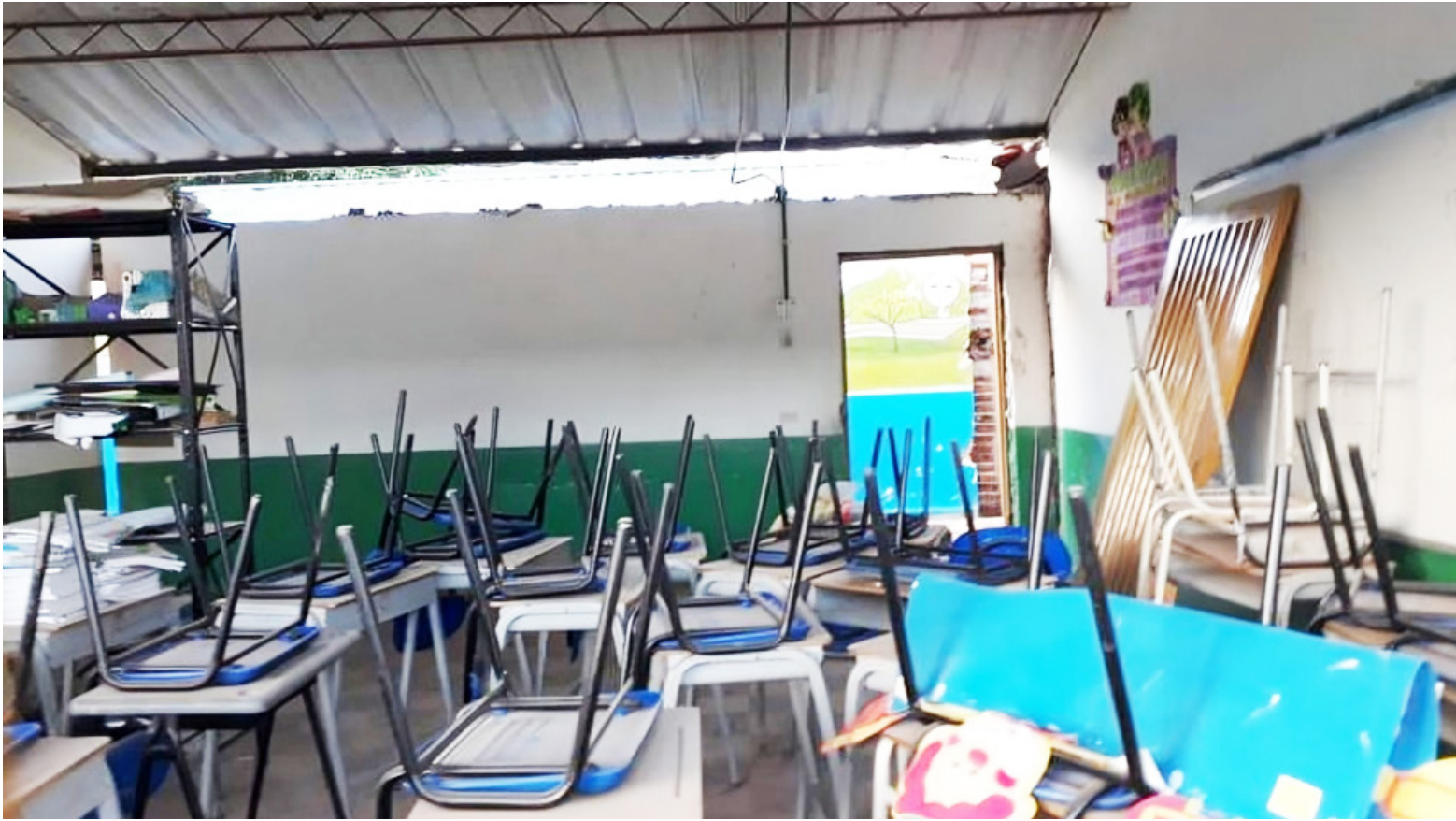
En 2019, la sede Herminia Escorcía Pérez tuvo fallos en su estructura luego de una mala intervención.
