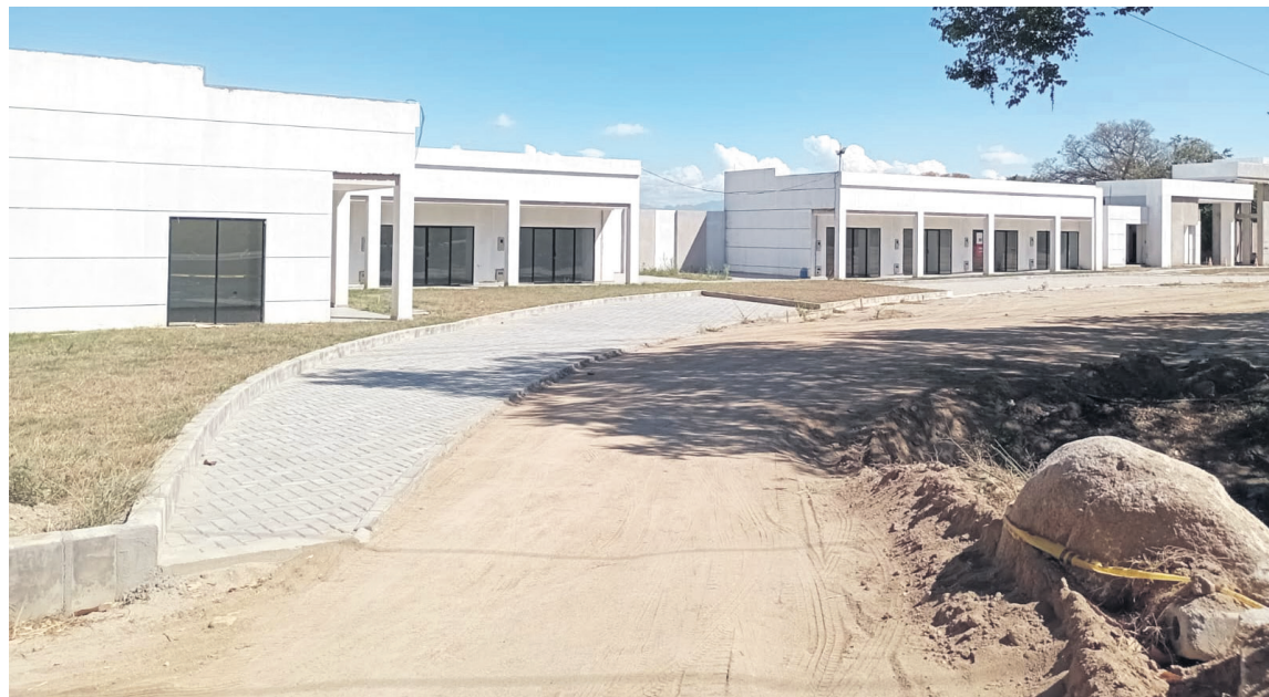
Construcción objeto de señalamientos.
