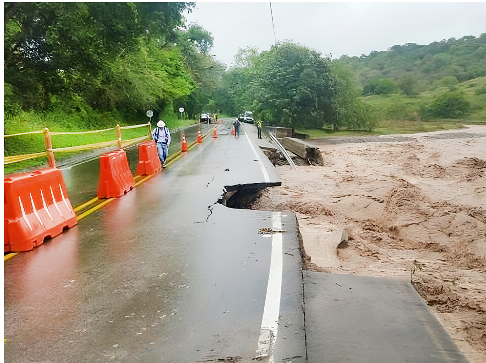
Entre las afectaciones por las lluvias, el plan identifica los daños a la infraestructura vial.
