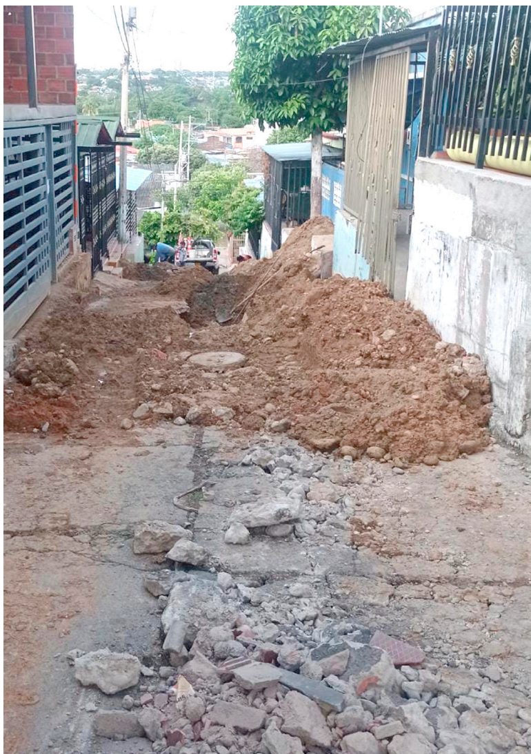
La problemática relacionada con la pavimentación es sobre la calle 7 sur, entre carreras 17 y 18 del barrio Emayá. Así se encuentra la calle en la actualidad.
