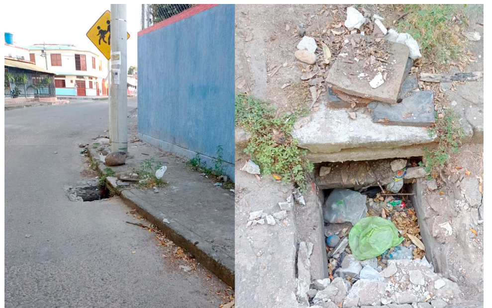
También han solicitado el cambio de la tubería recolectora de aguas lluvias de la Institución Educativa Agustín Codazzi, sede Emayá, ubicada en la carrera 20 No. 8 15.
