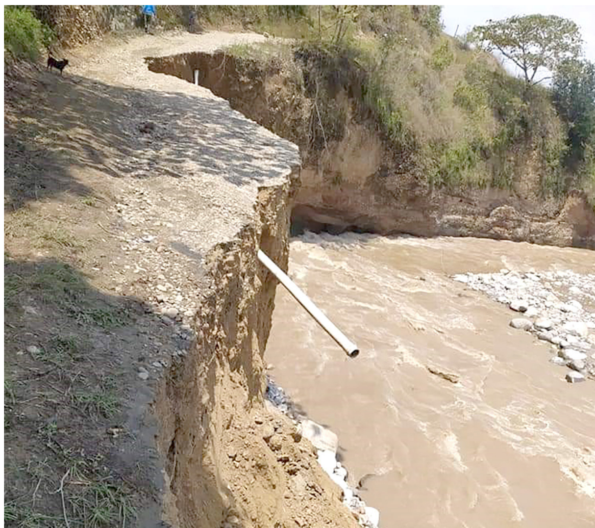
Así se encuentra actualmente la vía a la vereda La Mojarrá, zona rural de Neiva.
