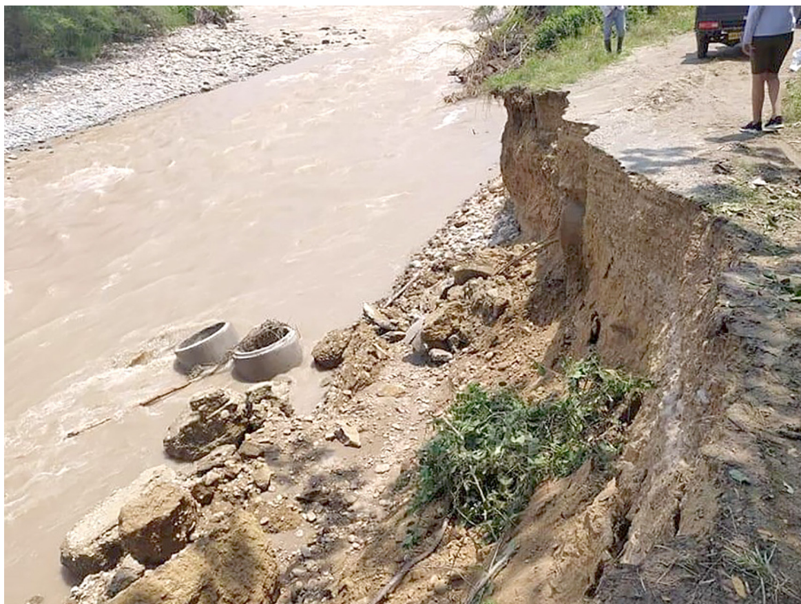
El río se llevó la banca de la carretera.
