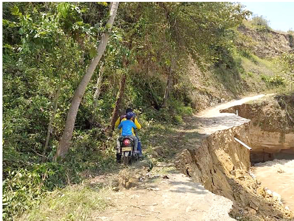
Estado en el que quedó la vía en la zona de la Mojarra.
