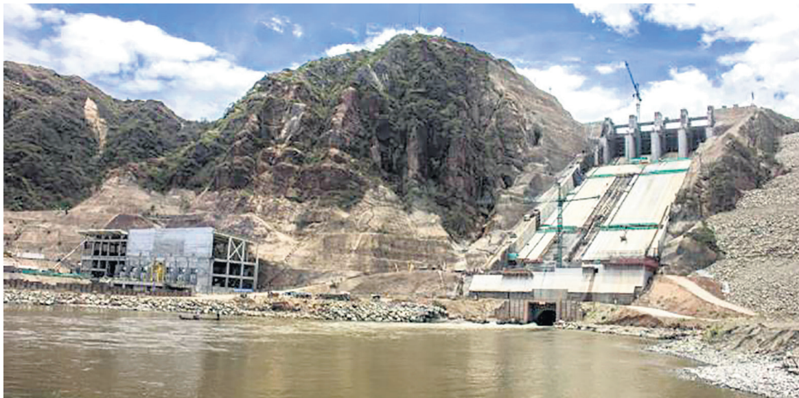
Desde su construcción habían sido denunciadas las fallas.
