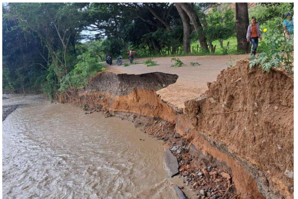
La localidad de Colombia, debido a las precipitaciones, siempre se queda sin vía de acceso.
