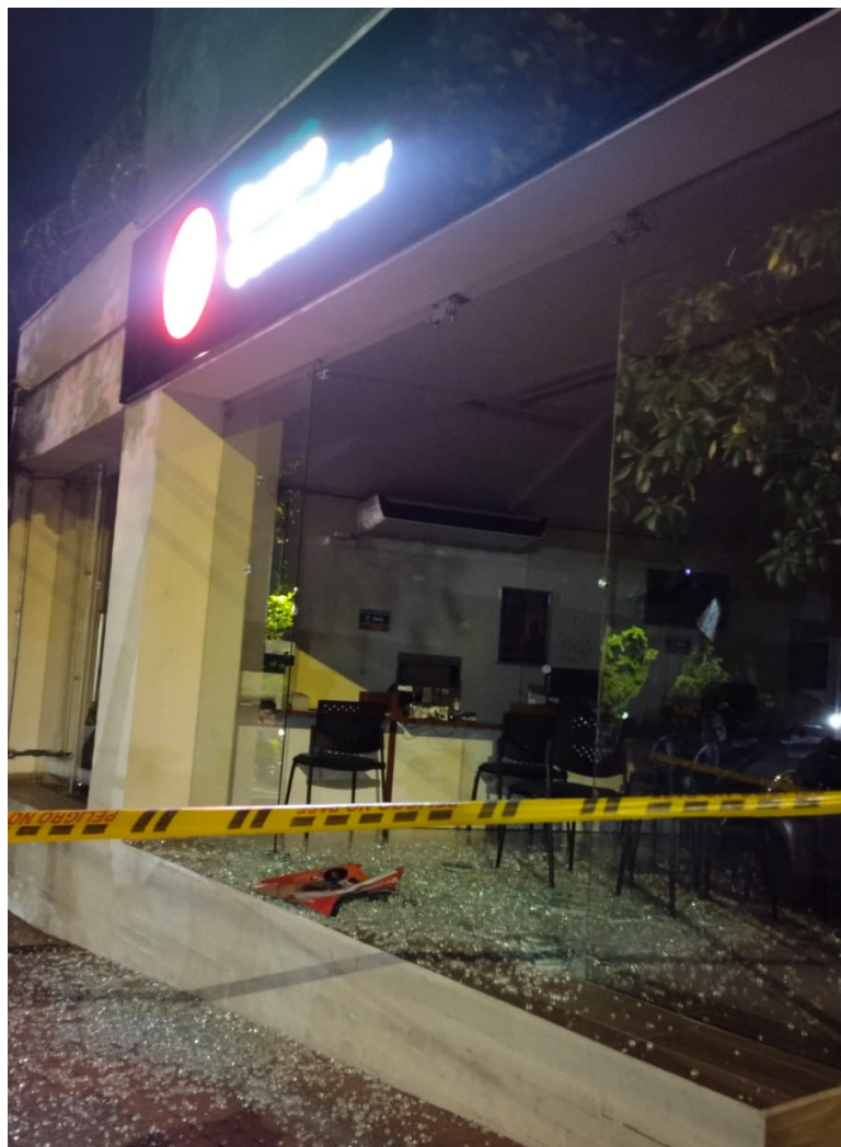
El banco Contactar sufrió afectaciones en su fachada.
